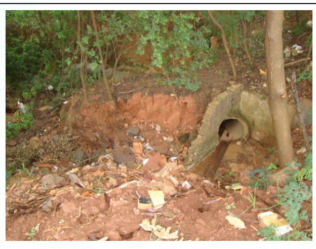
FOTO 28. Vista geral de sistema de controle das águas de superfície afetado por processos erosivos. Essas tubulações localizam-se a jusante do talude do lago mostrado na FOTO 27 .
