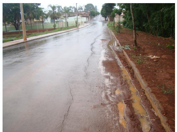
FOTO 32. Vista geral de arruamento, a jusante do lago, o qual apresenta sinais de movimentação do terreno (notar pavimento ondulado em direção à crista de talude de aterro).
