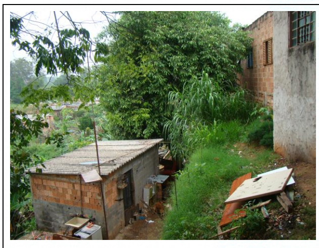
FOTO 7. Vista geral de talude de corte em encosta natural. Notar dimensões do talude de corte e espessura do solo residual.
