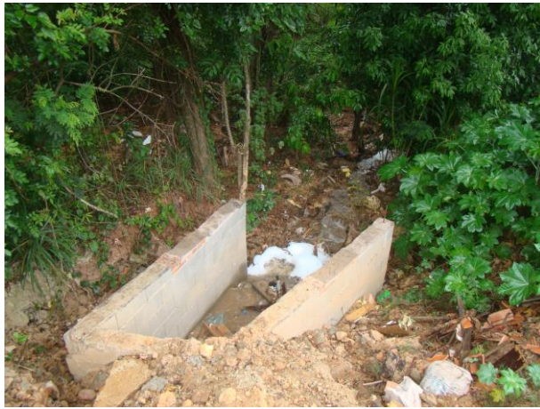
FOTO 45. Aspecto de obra para controle das águas de superfície. Esse ponto deverá ser monitorado em função do novo loteamento a montante e em função da manutenção do entorno da área.
