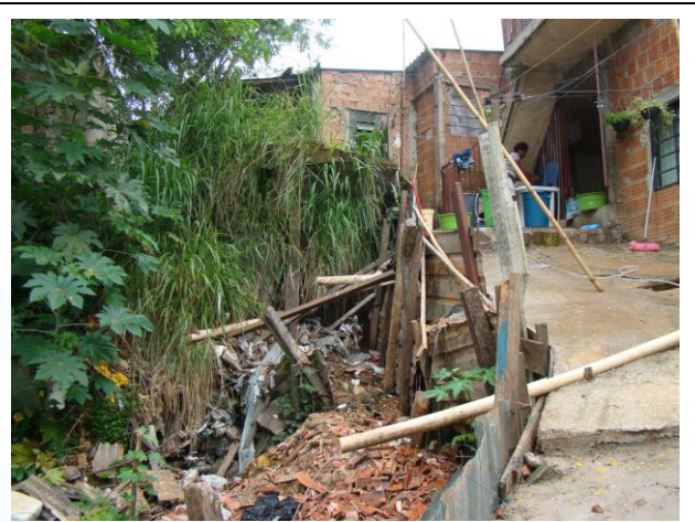
FOTO 2. Vista de talude de aterro e materiais lançados em superfície, principalmente entulhos. Notar dimensões e proximidade da moradia e lançamento de água em superfície (tubos de PVC expostos).
