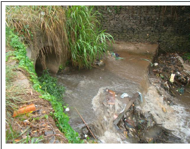
FOTO 23. Vista de sistema de condução e escoamento de água localizado a jusante, cerca de 20 m do ponto mostrado na FOTO 21.
