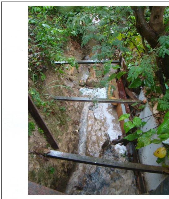
FOTO 33. Vista de trecho no qual há moradias construídas próximas a talude marginal. Notar dimensões da drenagens e dos taludes laterais.
