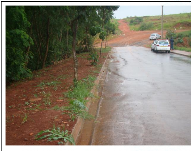
FOTO 31. Vista geral de arruamento, a jusante do lago, o qual apresenta sinais de movimentação do terreno (notar pavimento ondulado em direção à crista de talude de aterro).
