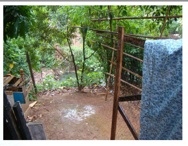
FOTO 10. Vista de talude marginal e córrego de pequenas dimensões, área sujeita a processos de inundação e solapamento de margem. O trecho em destaque já apresenta sinais de erosão marginal.
