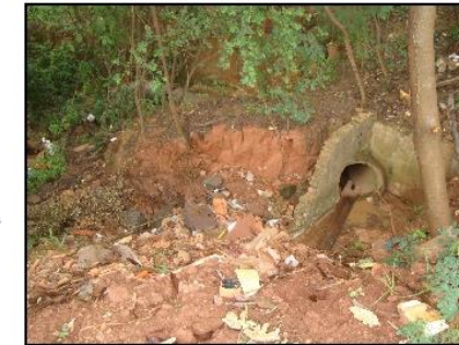
Vista geral de sistema de controle das águas de superfície afetado por processos erosivos.
