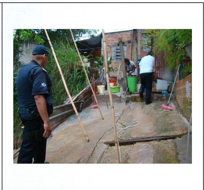
FOTO 4. Vista geral de talude e moradia. Notar sinais de movimentação do terreno (trincas na área cimentada).
